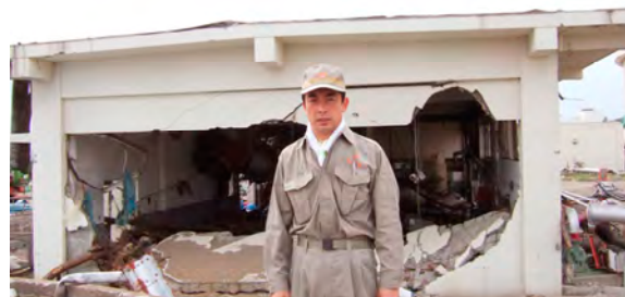
南蒲生浄化センターにおける被害状況
